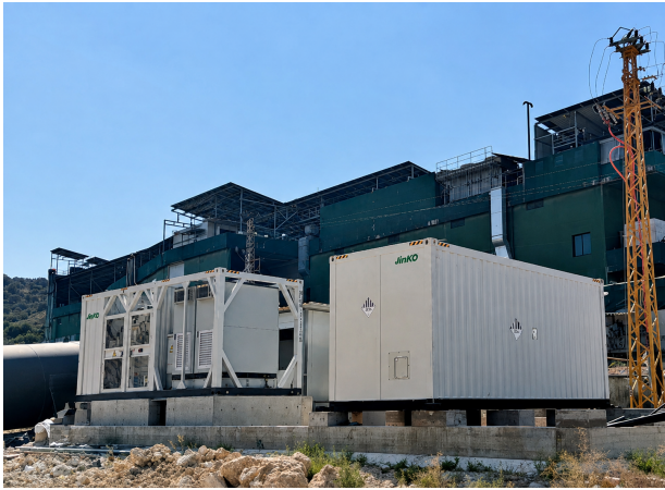
图3: PCS一体机，电气柜及SunTera 电池柜
